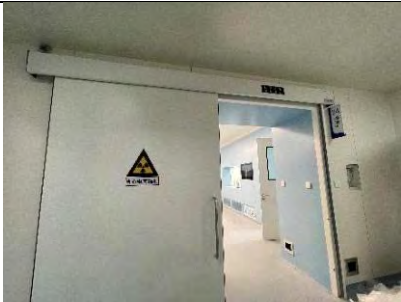
防护门外电离辐射标志和警示灯
