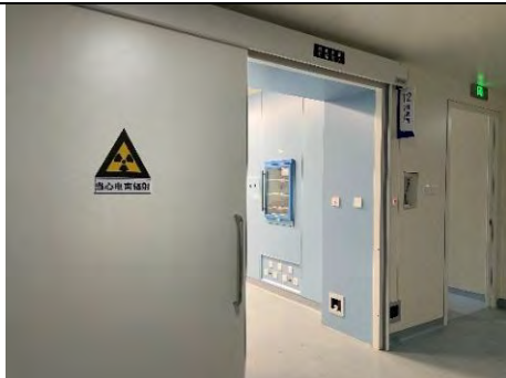
防护门外电离辐射标志和警示灯
