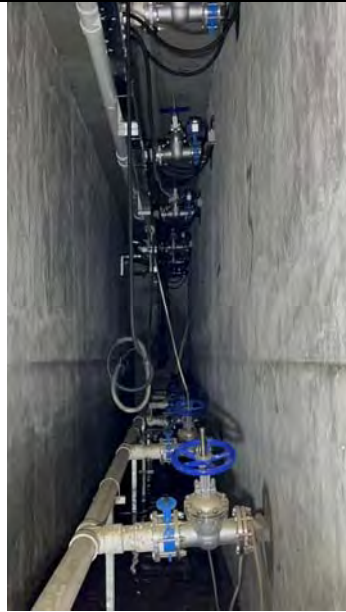
B类衰变池罐体 5个 (75m 3 /个)
