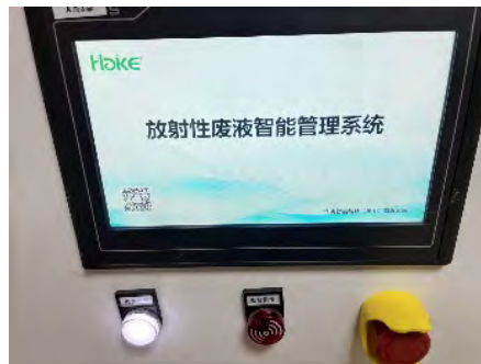
废水控制面板 1
