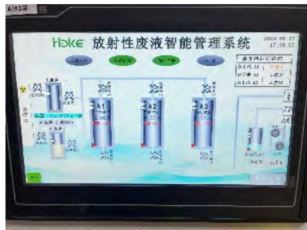
3个 A类放射性废水衰变罐控制面板
