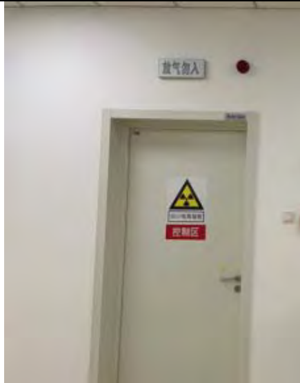
PET/CT 控制室防护门上放射性标志和分区标识
