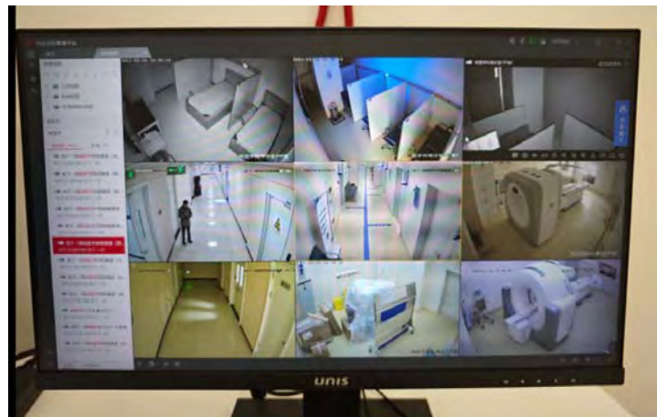
闭路监视系统（部分）
